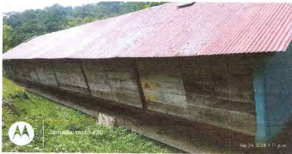
Foto1: laminas en mal estado y deteriorado
